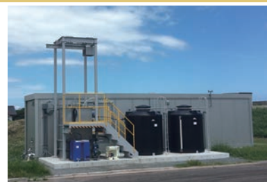
築上町液肥濃縮施設
